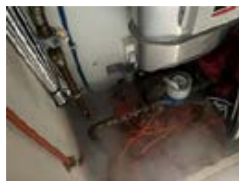
Luchtlekken in de meterkast
